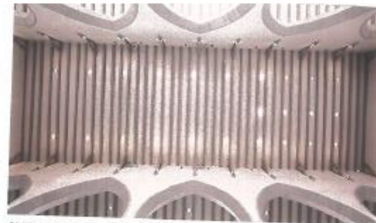
Die Kirchendecke mit grau abgesetzten Deckenbalken passt sich harmonisch in die neue Gestaltung ein.
